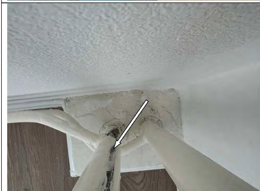
Фото №48. Окрашивание труб отопления выполнено с дефектами (не прокрашено) в кухне.
