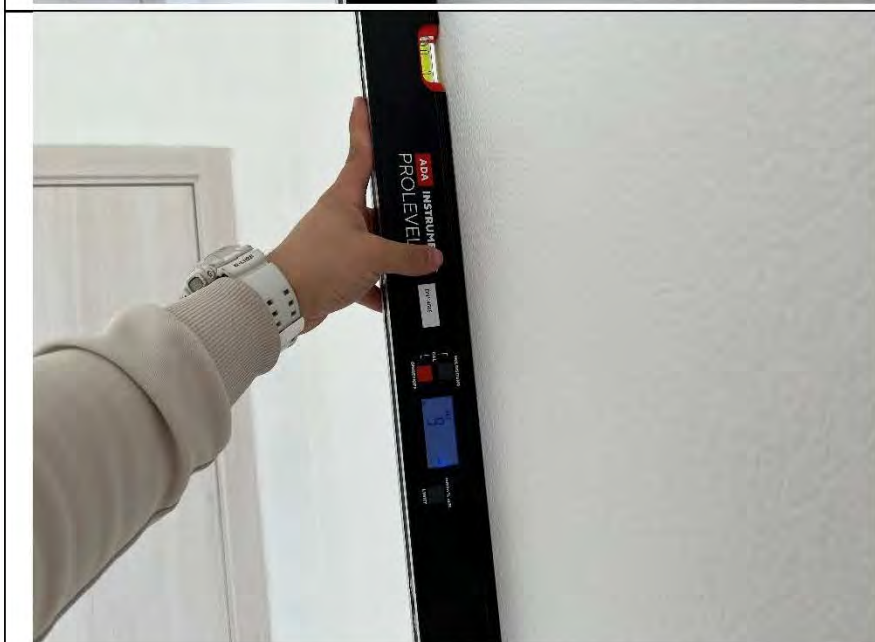
Фото №17. Отклонение стены на 6 мм от вертикальной плоскости в спальне.
