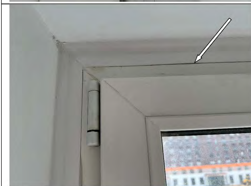
Фото №27. Зазор между наличником и оконной рамой в кухне.
