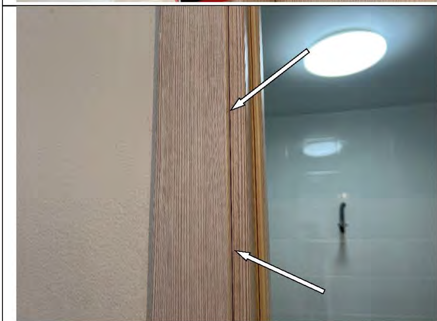
Фото №45. Элементы дверного блока соединены не надежно в ванной комнате.
