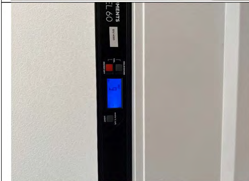
Фото №38. Отклонение наличников входной двери на 6 мм от вертикальной плоскости.
