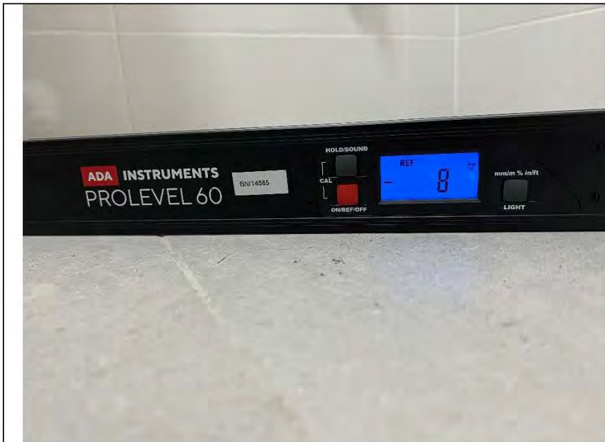
Фото №25. Отклонение напольной плитки от плоскости на 8 мм в ванной комнате.
