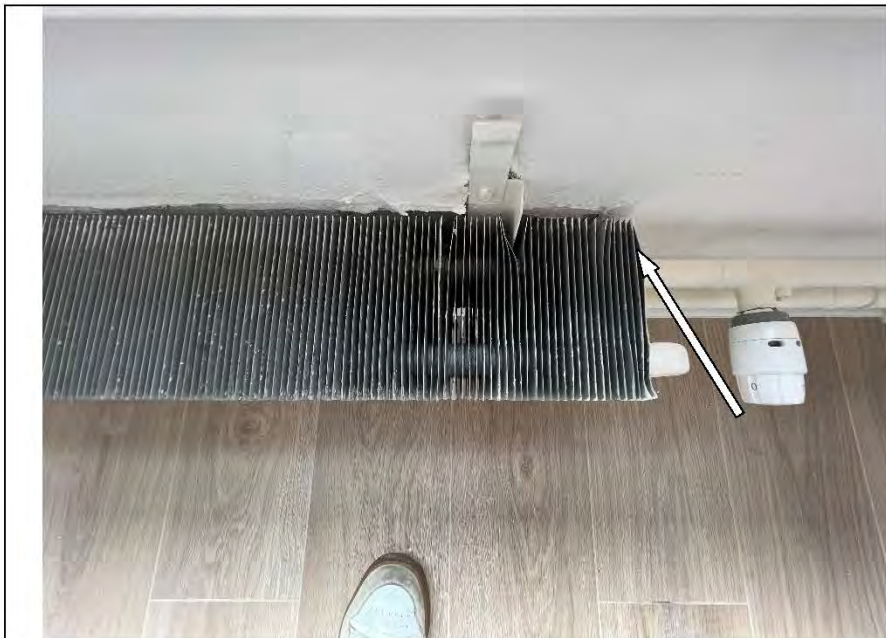
Фото №52 Радиатор в кухне имеет дефекты (замятия).
