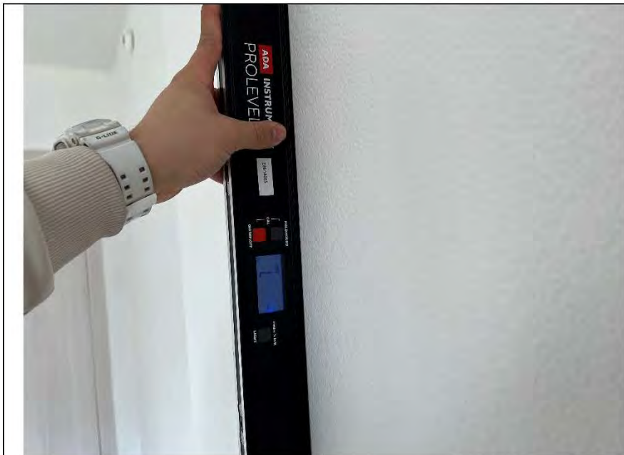
Фото №16. Отклонение стены на 7 мм от вертикальной плоскости в спальне.
