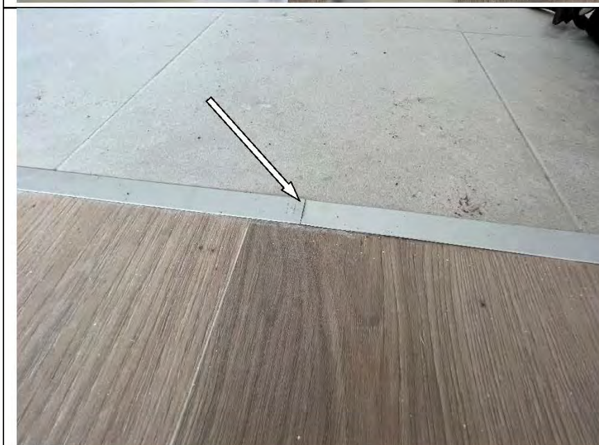
Фото №50. Металлический порог в кухне выполнен с дефектом (щель в стыке).
