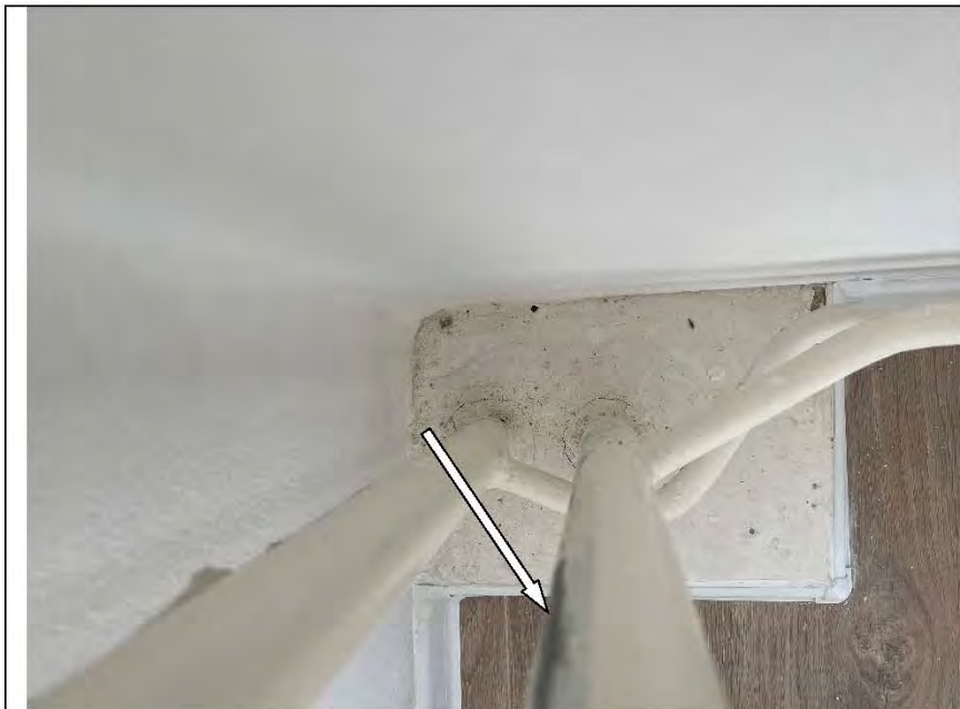
Фото №49. Окрашивание труб отопления выполнено с дефектами (не прокрашено) в спальне.
