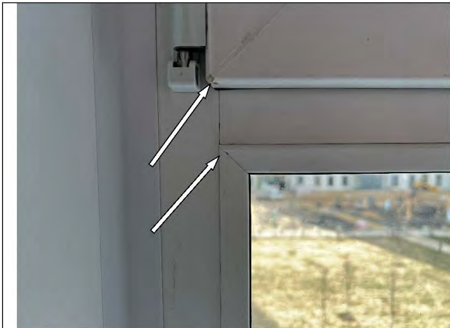
Фото №31. Механическое повреждение рамы створки оконного блока в спальне. Некорректная подрезка штапиков глухого окна в спальне.
