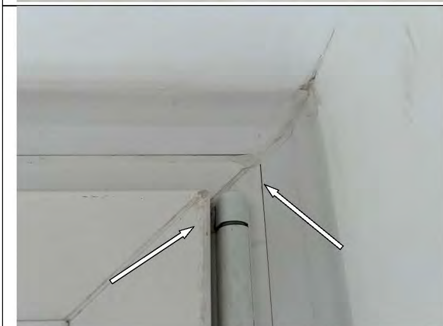
Фото №26. Зазор между наличником и оконной рамой в спальне. Механическое повреждение рамы створки оконного блока в спальне.
