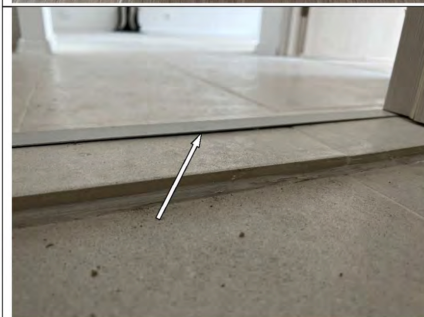
Фото №51. Металлический порог в ванной комнате выполнен с дефектом (щель в стыке).
