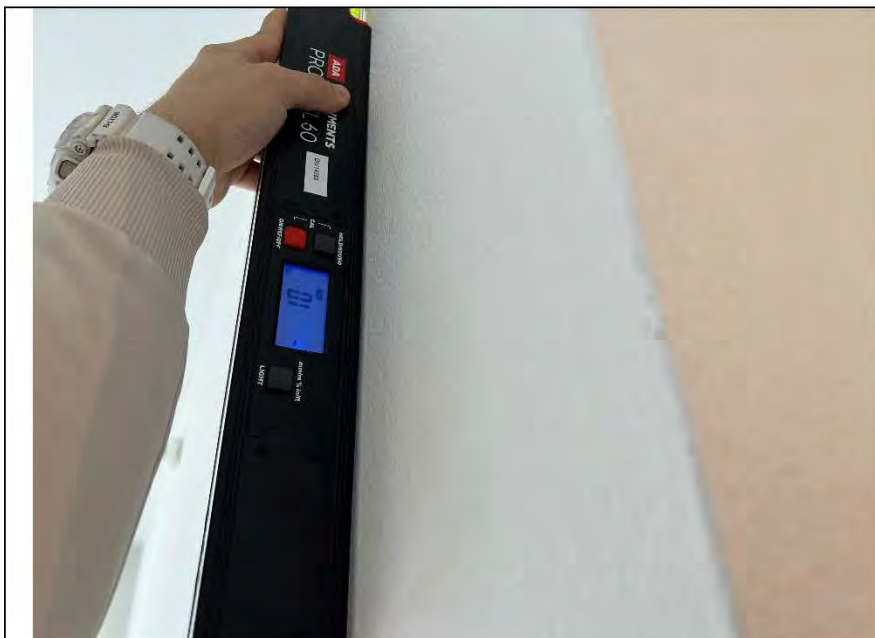
Фото №13. Отклонение стены на 10 мм от вертикальной плоскости в кухне.
