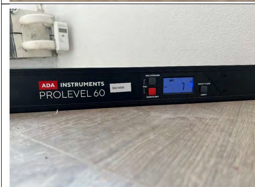
Фото №24. Отклонение ламината от плоскости на 7 мм в спальне.
