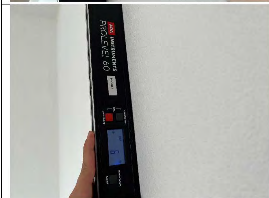
Фото №14. Отклонение стены на 6 мм от вертикальной плоскости в спальне.
