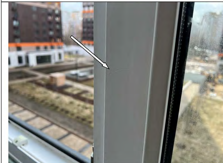
Фото №32. Механическое повреждение рамы оконного блока в спальне.
